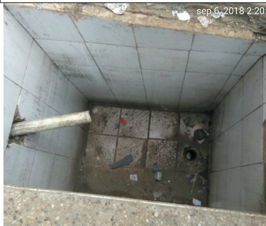
Foto No. 6 Punto de descarga ARnD del proceso de curtido de pieles KR 18 D
