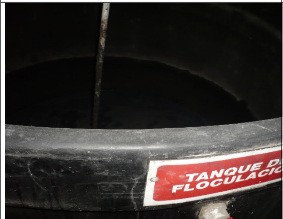
Foto No. 3 Proceso de floculación en Planta de Tratamiento
